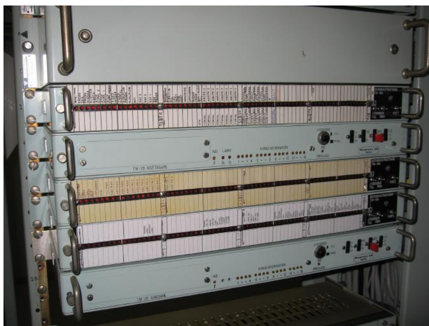
Figur 5: Övervakningsutrustningen på en PS-810 anläggning
